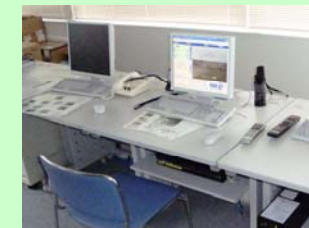
管理設備(監視装置)
