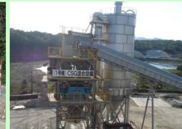
仮設備(CSG材製造設備)
