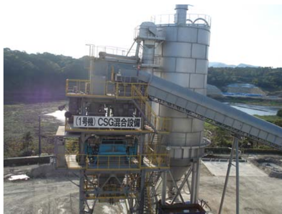
CSG材製造設備(他ダム事例)
