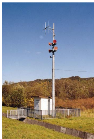
警報設備 (他ダム事例)
