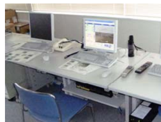
画像監視装置 (他ダム事例)
