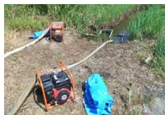
ポンプアップによる他系統用水の反復利用(H24.8月 川口下中島揚水機)
