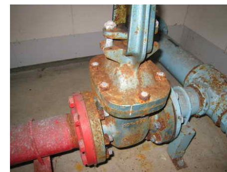
簡易水道施設の老朽化状況
