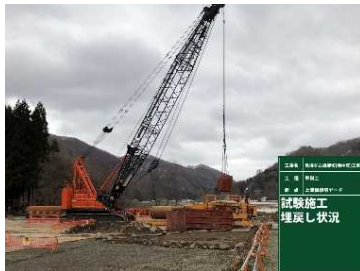
写真-5 埋戻し状況 必要な深度まで掘削後、置換え材を埋戻します。
