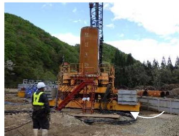
写真-2 掘削状況(ケーシング回転削孔) ケーシングを回転圧入します。
