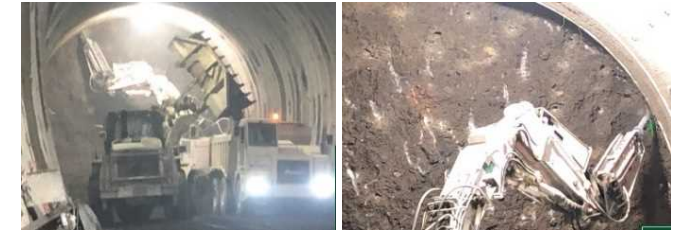
ズリ出し・コンク作業状況【写真-3】 発破で砕いた岩(ズリ)を外に搬出してしています。また、発破によって掘削した後、岩盤面に残った浮き石を除去します。
