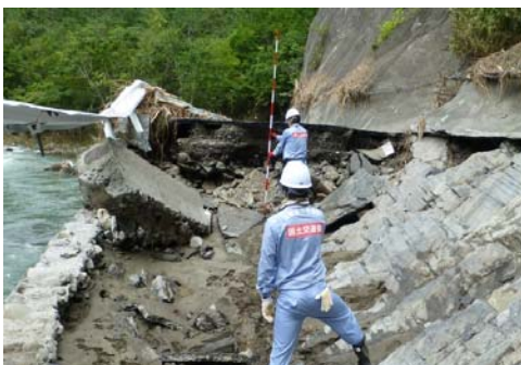
▲ 被災状況調査
