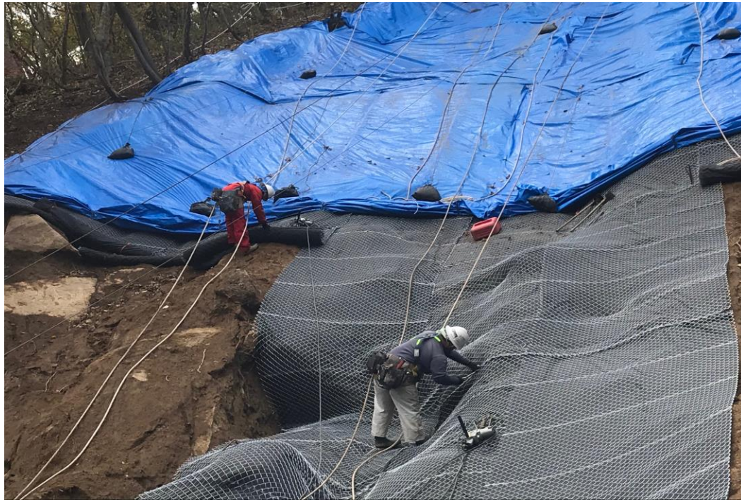
相馬福島道路(9.75kp(下り)) 2019.11.16 11時00分 侵食防止シート設置作業状況
