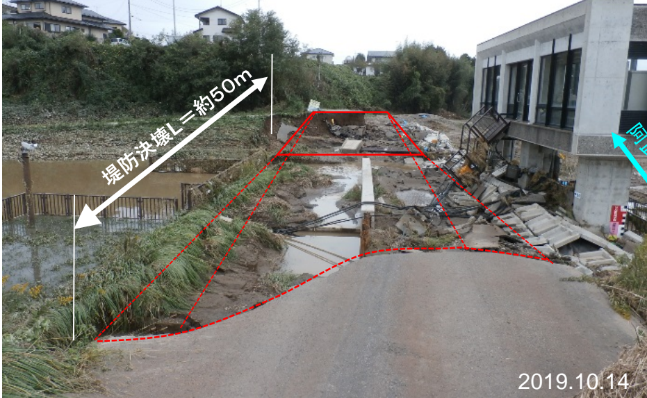
【阿武隈川左岸98.6K 決壊箇所】
