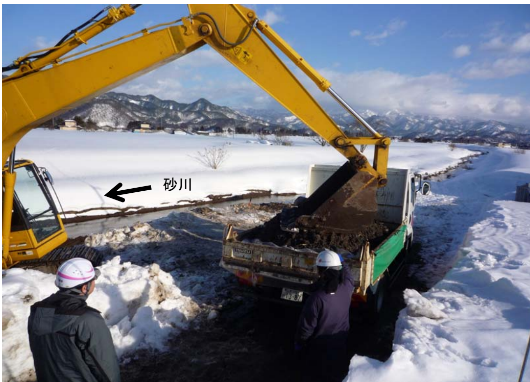
2月16日 原因者による重油を含んだ土砂の搬出 水路出口付近(砂川)
