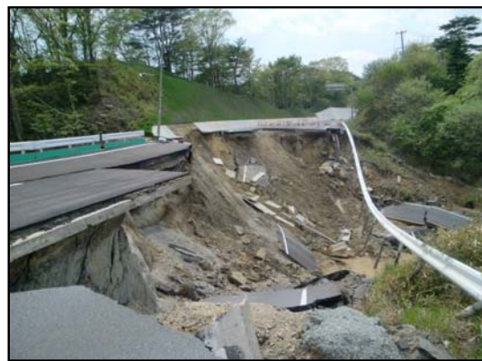
【被災後の状況】
