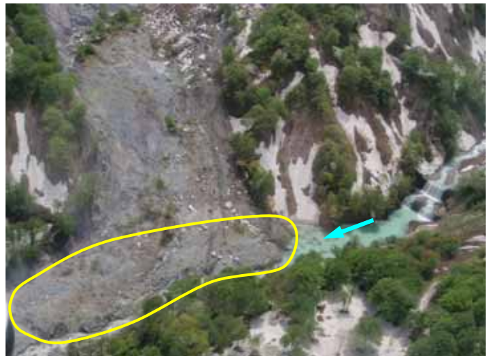
崩落斜面脚部
