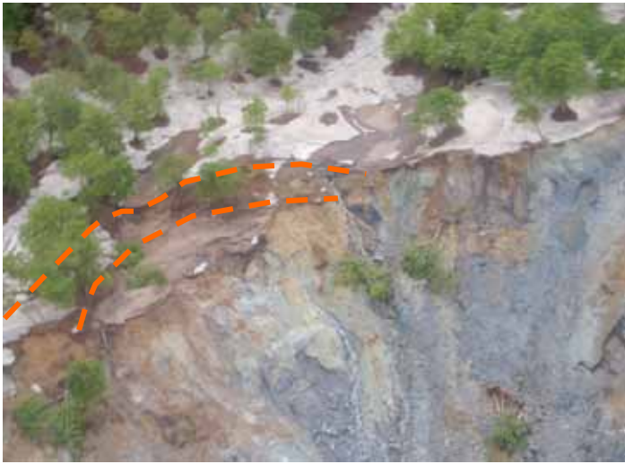
上部のクラック
