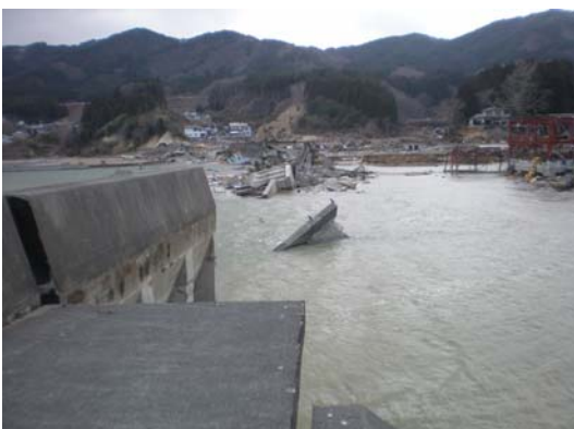
防波堤の被災状況
