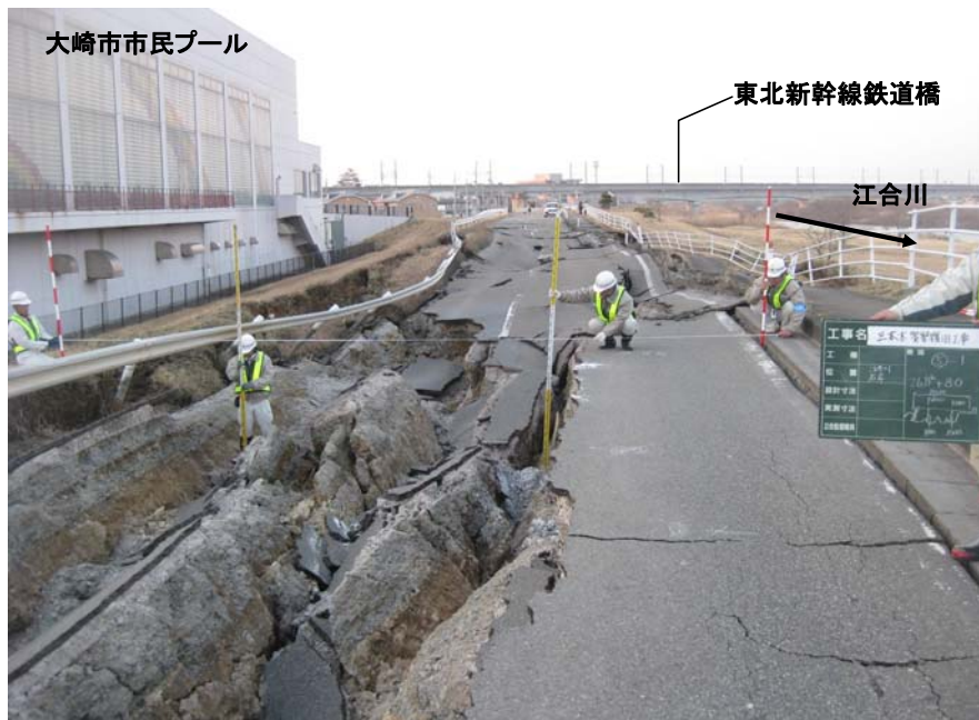
3月17日堤防被災状況 堤防亀裂・沈下
