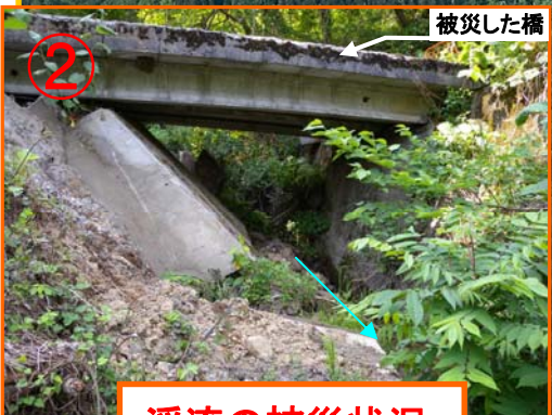
溪流の被災状況
