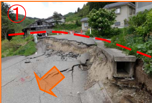
人家周辺の被災状況
