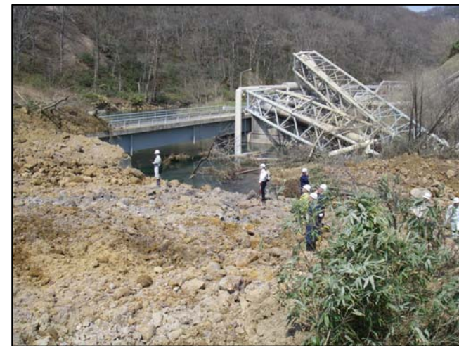
配管損壊状況
