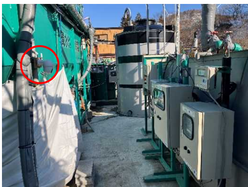
監視カメラの設置 (水質監視用)
