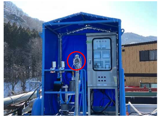
監視カメラの設置 (水質監視用)
