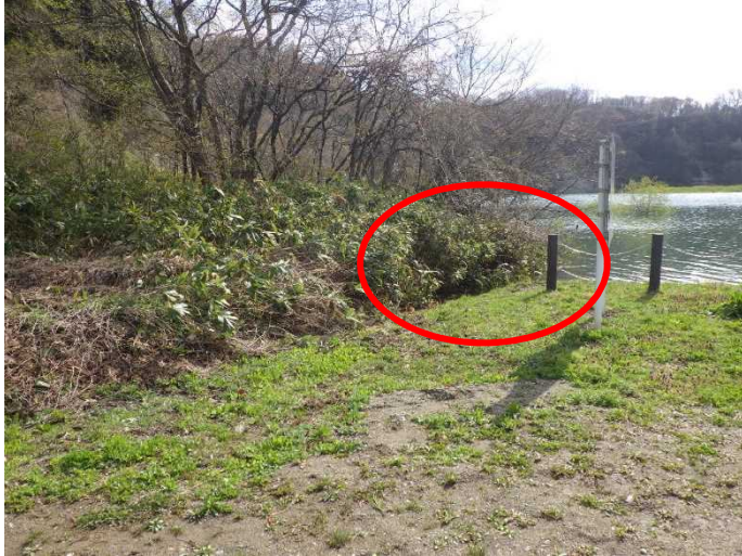
①貯砂ダム(立入禁止柵の端部に隙間)
