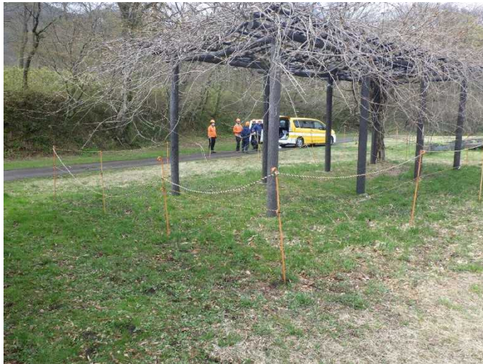
②荒雄湖畔公園(立入禁止柵のロープの緩み)
