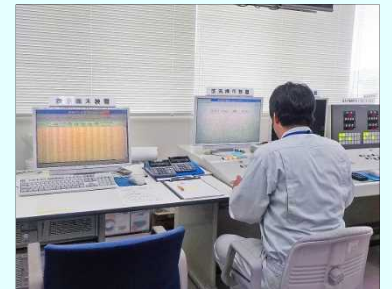
▲ 操作室の状況
