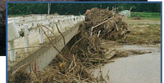
◆ダムがなかった場合◆ 橋に引っかかった流木（事例）
