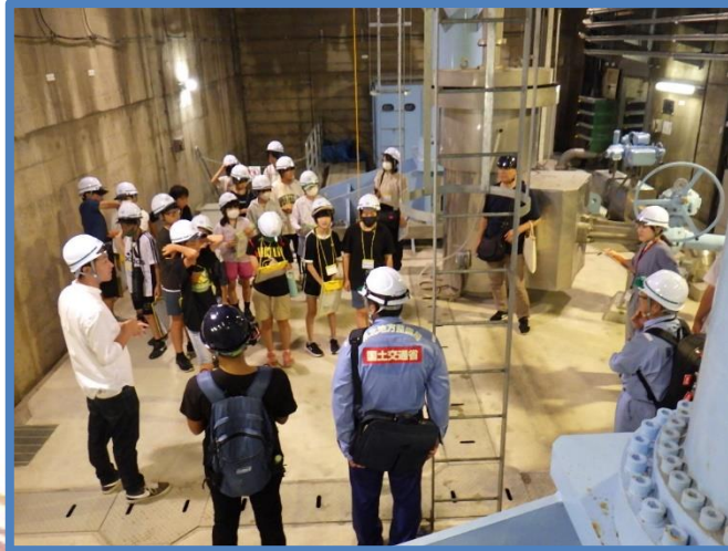
ほうりゅうせつびしつ 放流設備室のようす
