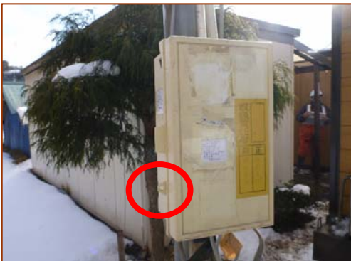
分電盤の施錠無し
