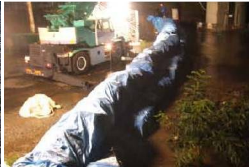
写真 1-1 平成19年9月17日洪水時の盛岡市街地における土のう積み作業の状況
