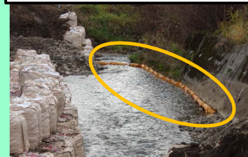
河川への油流出対策が行われている
