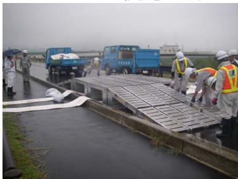
↑堤防上の町道には緊急車両が通行できるようにホースブリッジを設置。
