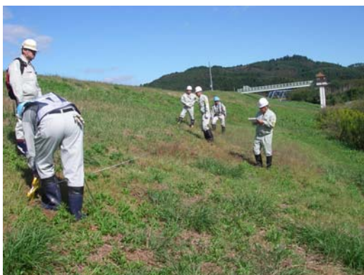
堤防詳細点検の様子。堤防の状態が分かるように除草をおこなった後に実施します。
