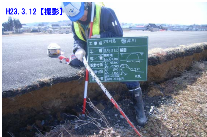
【周囲堤防の被災状況】 地震により発生した段差
