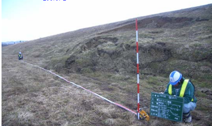
【周囲堤防の被災状況】 地震により崩落した堤防法面
