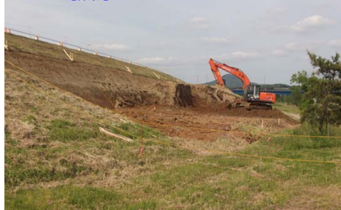
【磐井川下流堤防の復旧状況】 地震により崩落した箇所の掘削状況です。周囲堤防と同様に、新しい良質な土で盛土します。
