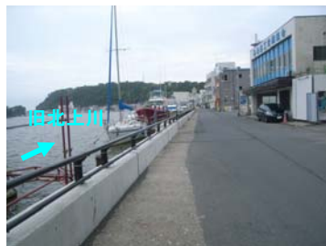
浸水防止壁 (平成14年7月洪水と同規模の水位に対する緊急対策)
