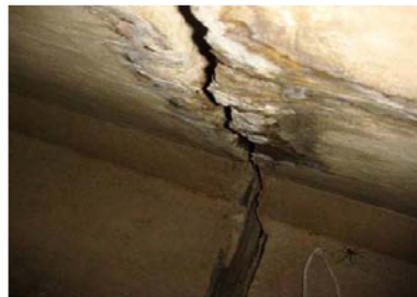
樋管函体のクラック発生状況
