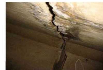
樋管函体のクラック発生状況
