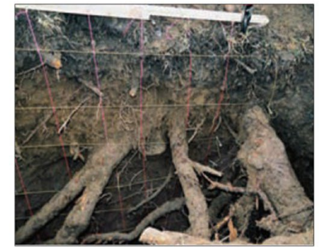
桜の根の堤防侵入状況(根の腐食による空洞化)
