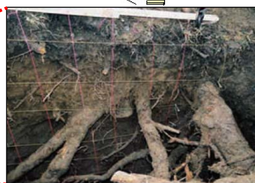
桜の根の堤防侵入状況(根の腐食による空洞化)
