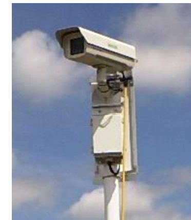
簡易型河川監視カメラ
