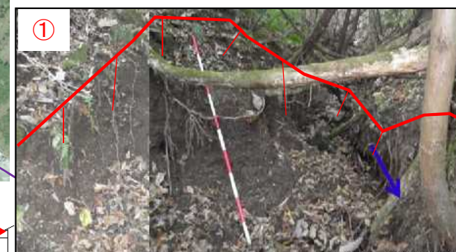
溪岸浸食状況
