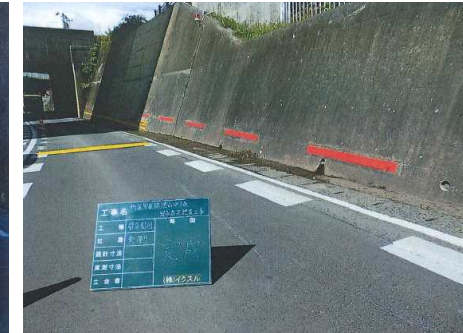
壁面浸水深表示
