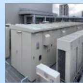
電気設備の設置場所の高上げ
