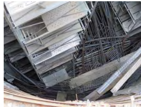
崩れ落ちた帯鉄筋・中間帯鉄筋
