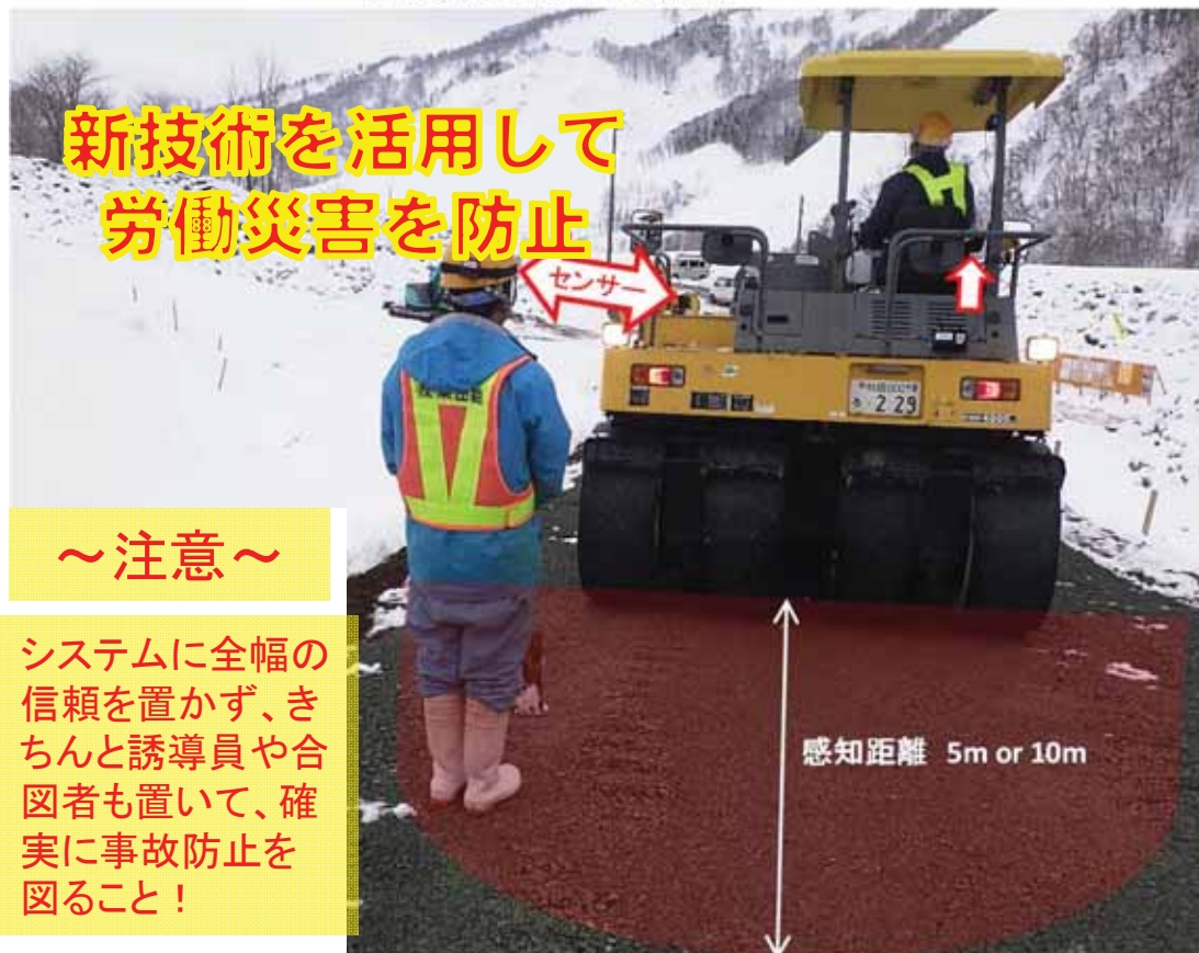
作業員装着警報システム 使用状況
