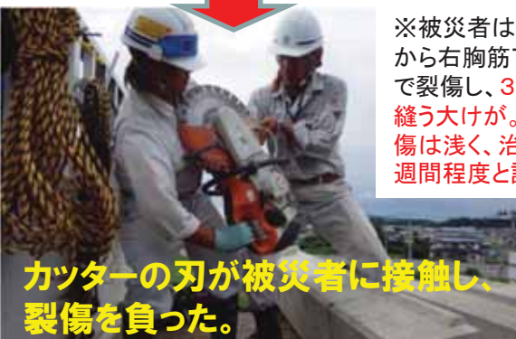
切断面の摩擦によりエンジンカッターの刃が被災者に跳ね返る。
