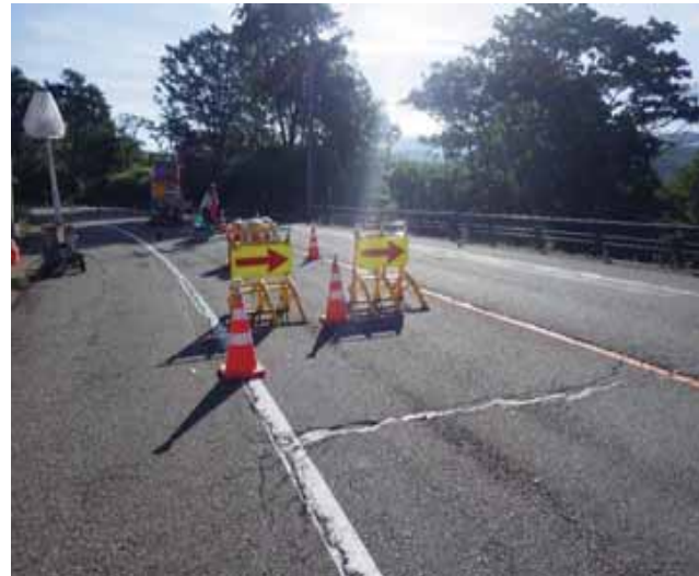
一般車両がスピードの出し過ぎにより保安施設に接触。保安施設により作業員等には被害無し。
