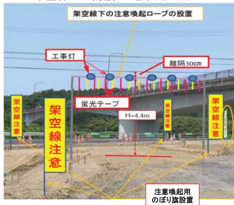
架空線下の防護・注意喚起の例
