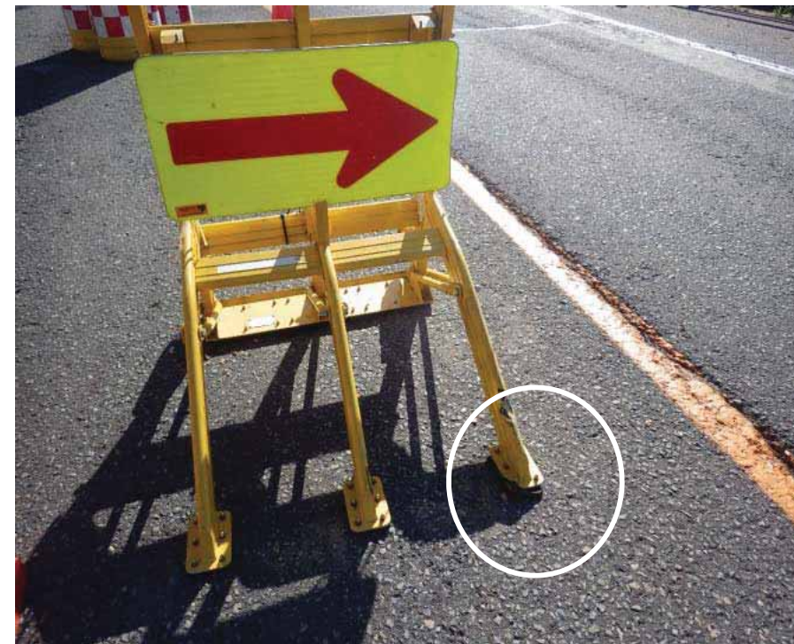
一般車両がぶつかり保安施設が部分破損
