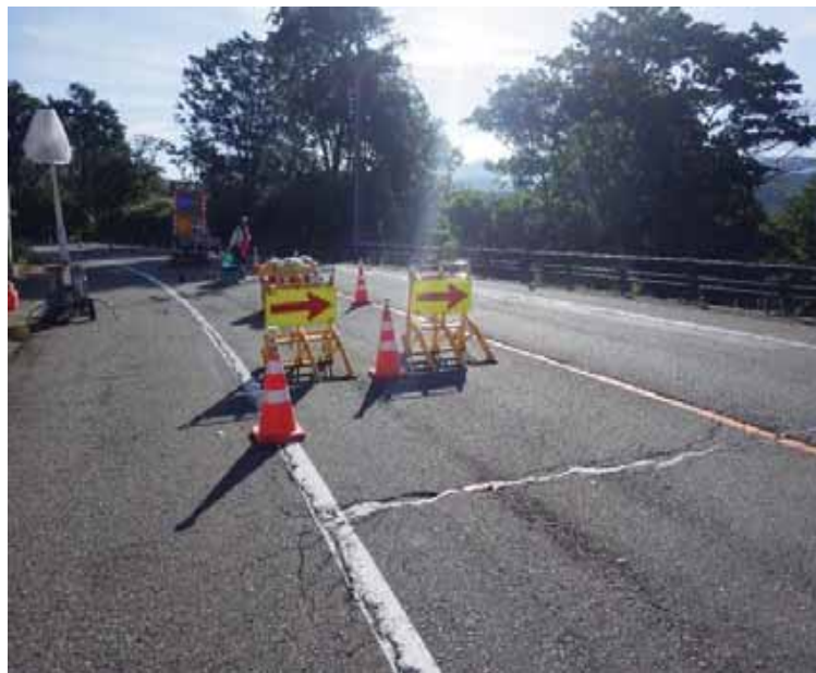
一般車両がスピードの出し過ぎにより保安施設に接触。保安施設により作業員等には被害無し。
