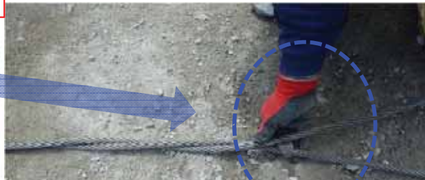
ロープに指をおいたまま吊り上げを行なったため、指がロープに挟まれた
