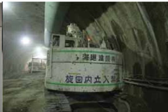
積層パトランプ取付状況
