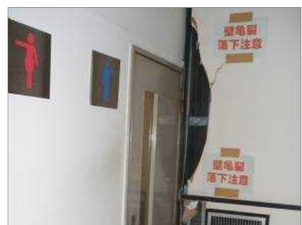
内壁 破損 (震災時)
