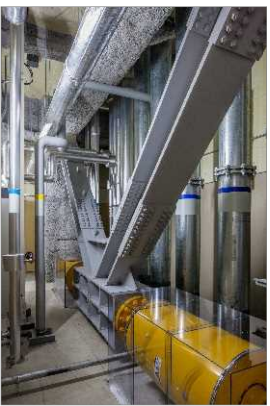
制震ダンパー(黄色部) 制震ブレース
