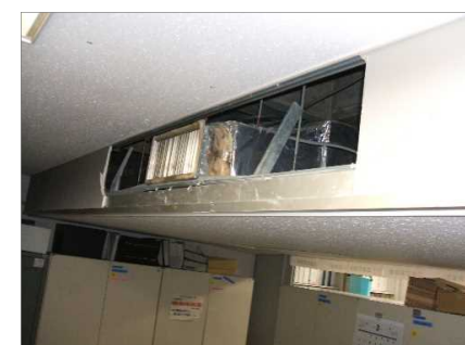
天井 破損・落下 (震災時)
