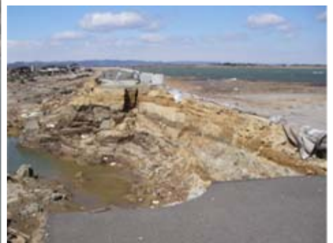
荒浜地区陸側を下流から望む (河口から右岸 0.0k付近 巨理町荒浜地先)
