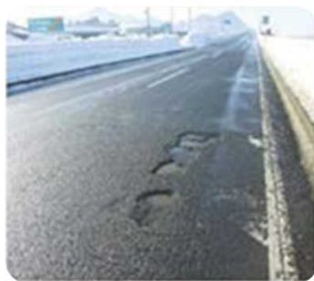
路面の穴ぼこ・ 段差
