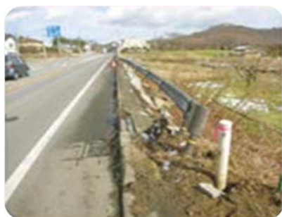
ガードレール・ 標識等の損傷
