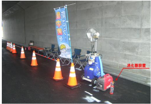
消火器を設置することにより、発火による危険を防止できる。
