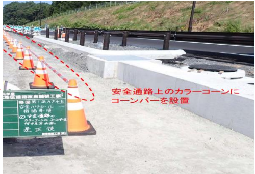
コーンバーを設置することにより、歩行者が入らないように明示できるだけでなく、安全が守られる。
