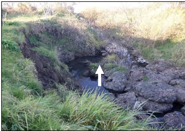
堤外水路【浸食状況】
