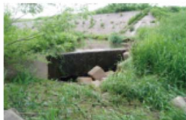
合流部で段差が生じている水路
