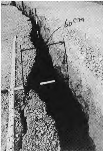
堤防天端の縦断亀裂（藻川築堤）
