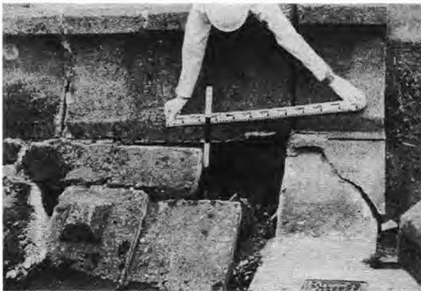
右岸囲繞堤のブロック破損
