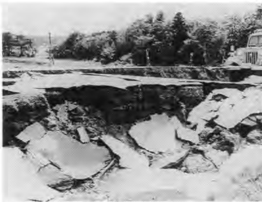
陥没した道路 (西津軽郡木造町)
