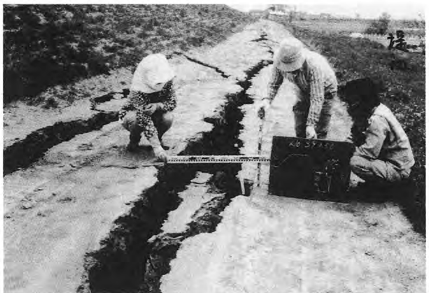
豊富築堤被災状況 (裏小段の亀裂)
