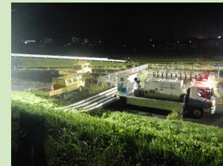
排水ポンプ車
