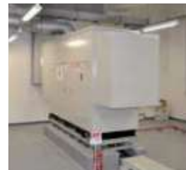
非常用発電設備のイメージ
