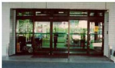
本館玄関への止水板設置状況（設置前） 出典）ヒアリングによる（H21.9.16）
