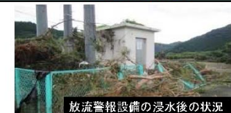
放流警報設備の浸水後の状況
