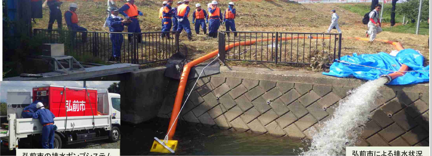
弘前市の排水ポンプシステム
