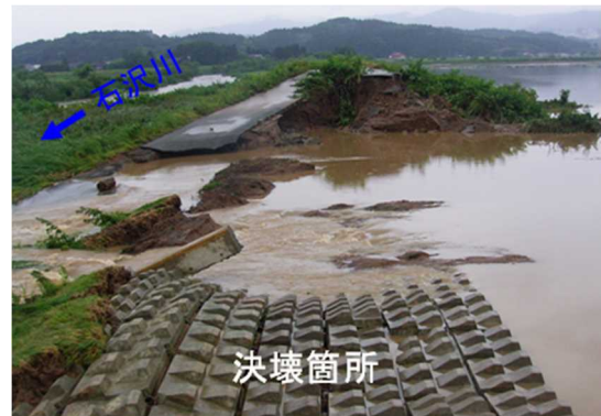
石沢川決壊箇所の様子
